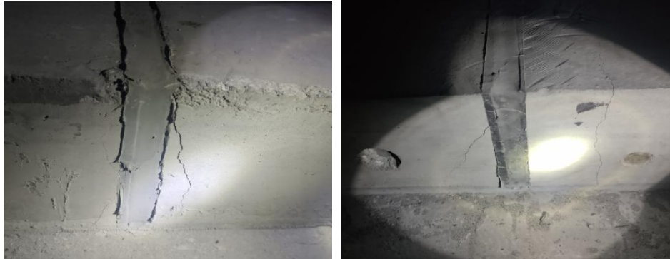
隧道仰拱开裂照片图
